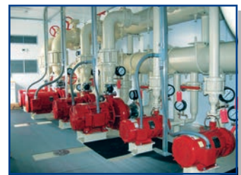
Өргөлтийн насос станц
